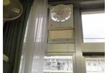
取り外しのできる窓用換気扇を設置。
